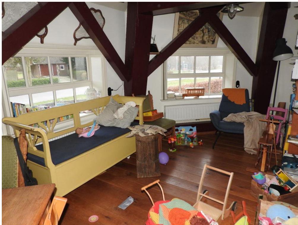
Foto 57. Overzicht van de voorzetwanden op de begane grond.
