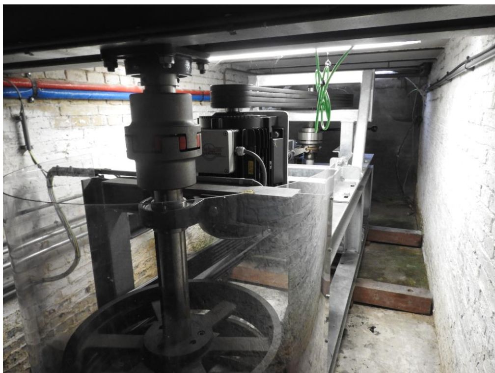
Foto 10. Overzicht van de generator in de voormalige waterloop.
